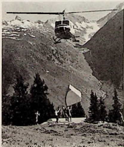
Afb. 4. Vaak moeten stations op moeilijk toegankelijke plaatsen worden opgericht waarvoor personen en materiaal met helikopters moeten worden getransporteerd. Hier het transport van een mastkabine-segment in het Kanton Graubünden.
